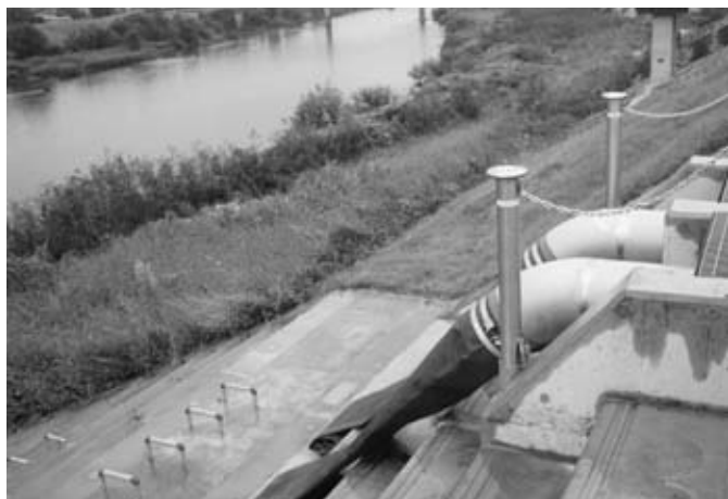
東町裏排水ポンプ場
