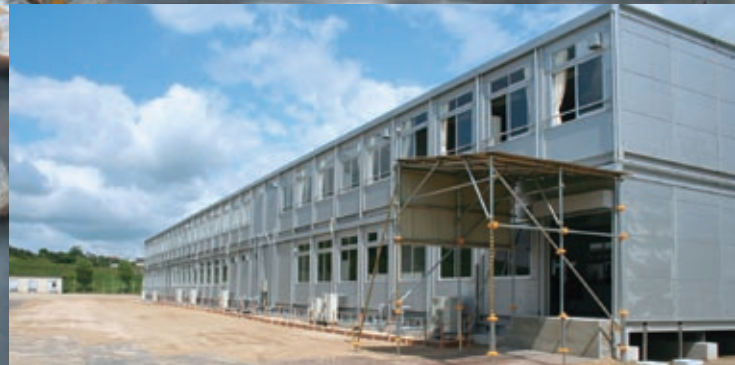
本宮第二中学校の仮設校舎。 プレハブ2階建2棟で、普通教室は10教室あります。
