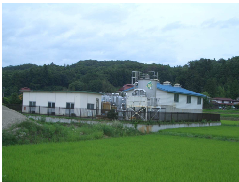
東禅寺浄水場
