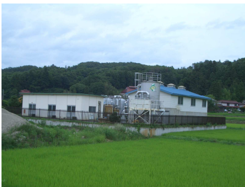
東禅寺浄水場
