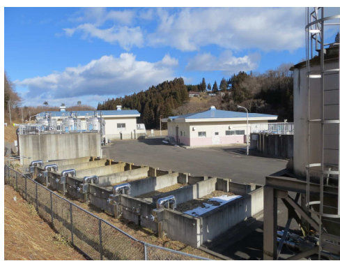
平田石浄水場
